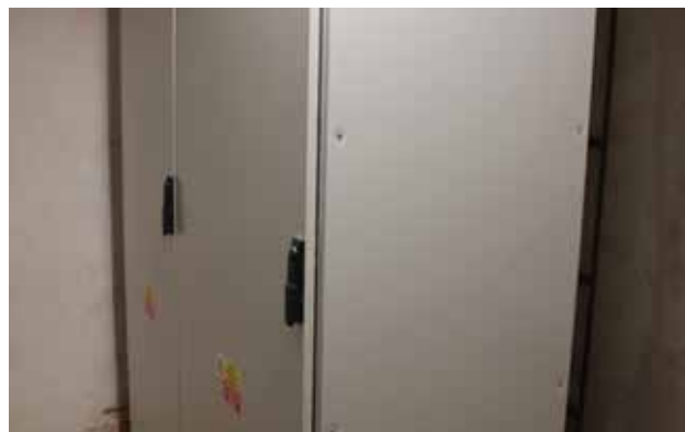
Výměna hl. rozvaděče v ZŠ Chuchelná - nový stav
