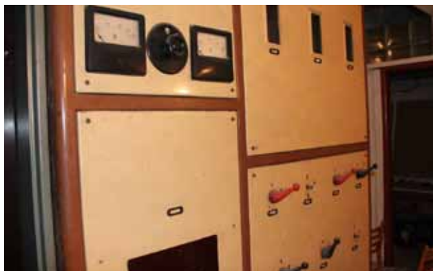
Výměna hl. rozvaděče v ZŠ Chuchelná - starý stav
