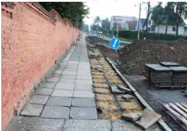
Oprava chodníku na ul. Komenského - starý stav
